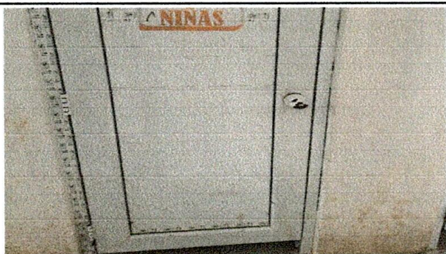
Foto 3: Chapas dañadas y puertas en mal estado
