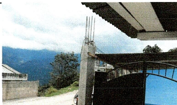
Foto 6: Techo en mal estado al igual que reglas de madera
