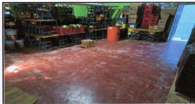
Foto 6: Sustrucción de piso de granito.
