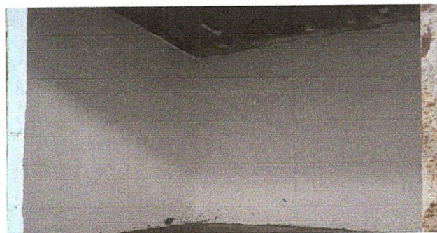
Foto 6: Pared en buen estado
