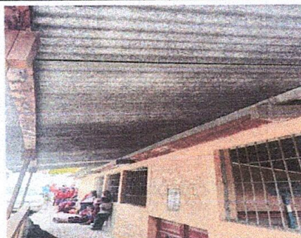
Foto 2: Sustrucción de techo con lámina deteriorada
