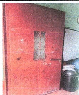
Foto 6: puertas con pintura deteriorada
