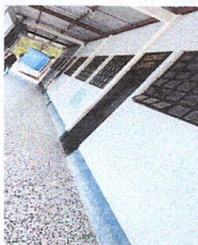
Foto 1: Pintura deteriorada dentro y fuera de las aulas
