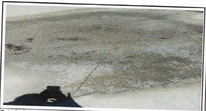
Foto 6: Daños en la terraza, que provocan la filtración de agua
