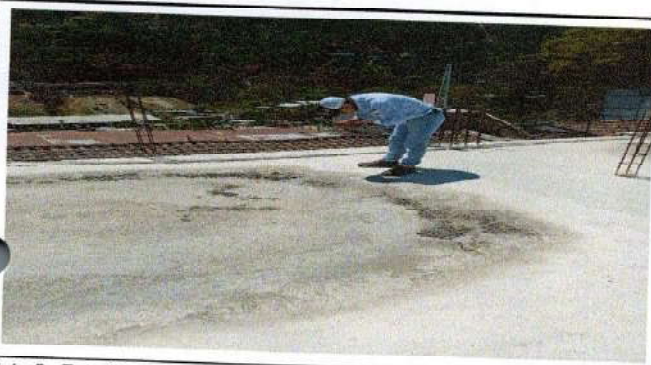
Foto 5: Estudio de daños en la terraza
