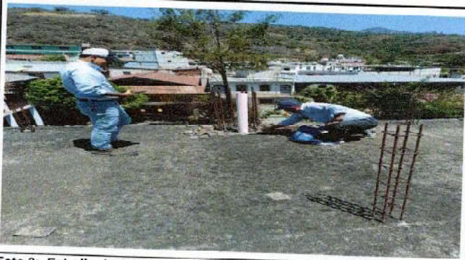
Foto 3: Estudio de caídas de agua en la terraza
