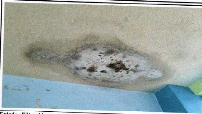
Foto 1: Filtración terraza corredor
