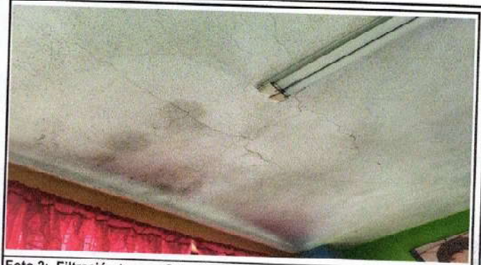
Foto 2: Filtración terraza Sala de Maestros
