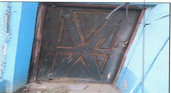
Foto 5: Puerta con necesidad de remozamiento (cambio)
