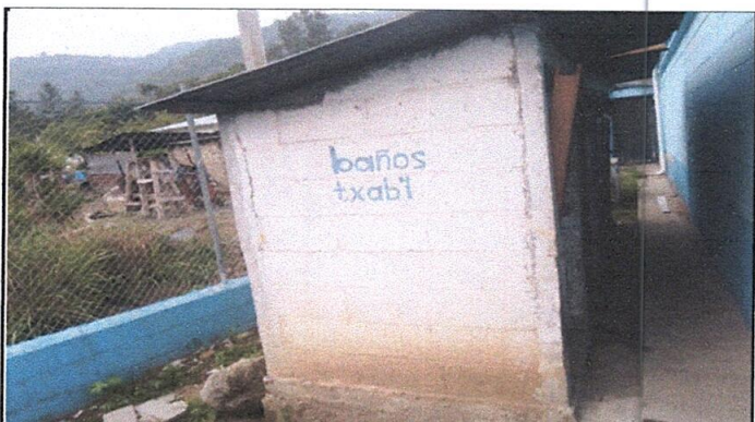
Foto 3: Remozamiento de sanitarios necesita remozamiento incluye, puertas, techo, paredes, piso, sistema de drenaje y agua
