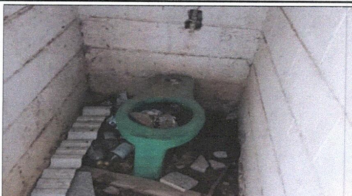
Foto 2: Sanitarios en mal estado con necesidad urgente de remozamiento (3 sanitarios)
