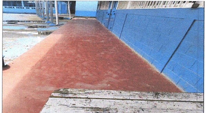
Foto 8: Piso de torta de cemento en mal estado de corredor de 3 aulas y cocina, necesita ser sustituido por piso de granito
