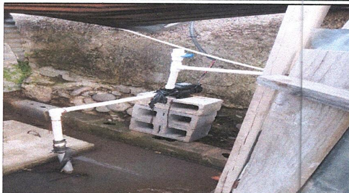
Foto 1: Distribución de sistema de agua en mal estado incluye bomba en mal estado
