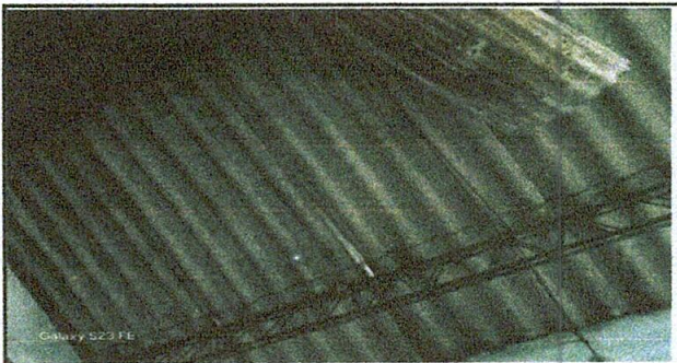
Foto 5: DURALITA QUEBRADA Y DAÑADA COMPLETAMENTE
