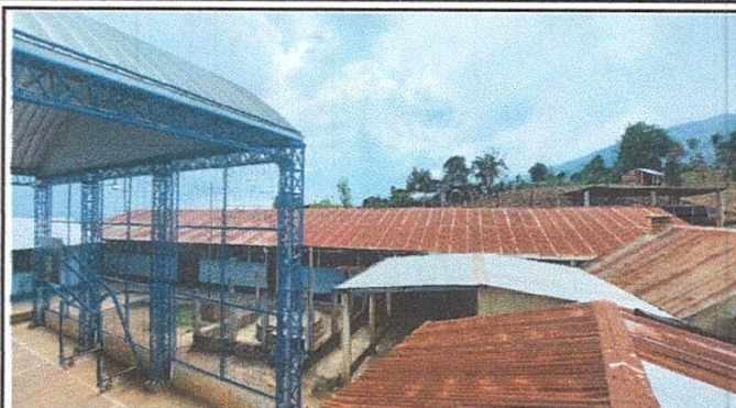
Foto 2: en las partes mas vulnerables el agua fluvial ingresa a las aulas
