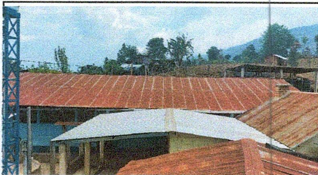
Foto 1: el techo contiene oxido
