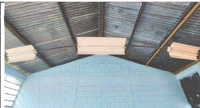
Foto 6: fueron desprendiendose al paso del tiempo
