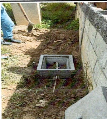
Foto 9: INSTALACIÓN DE CAJA PEQUEÑA DETERIORADA CAJA ADECUADA
