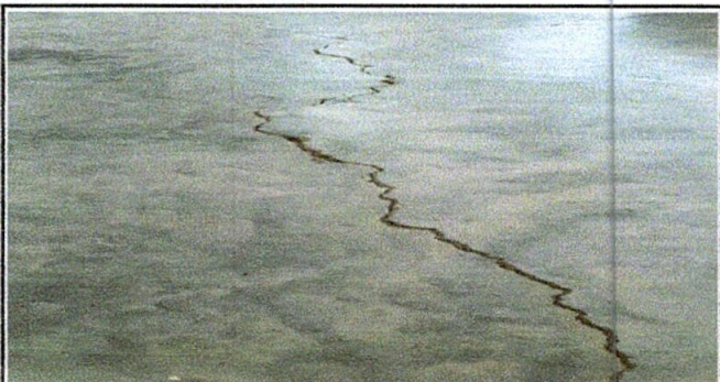
Foto 3: El piso de cemento se encuentra levantado.
