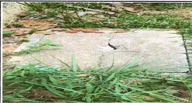
Foto 8: La caja de registro de agua potable se encuentra quebrada y sus accesorios presenta oxidación.
