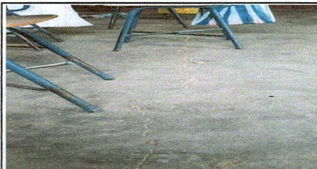
Foto 4: El piso de cemento se encuentra engrietado en varias direcciones.
