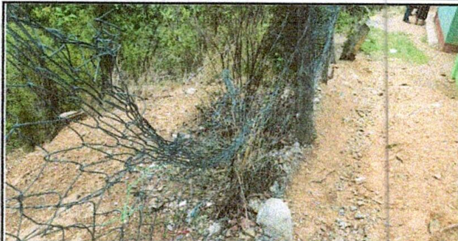
Foto 1: La malla se encuentra deteriorada
