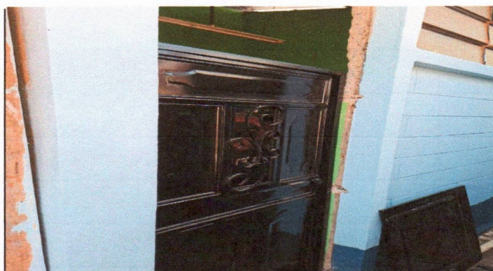
Foto 3: Sustrucción de puerta de 2.10 m. de alto por 1.02 m. de ancho
