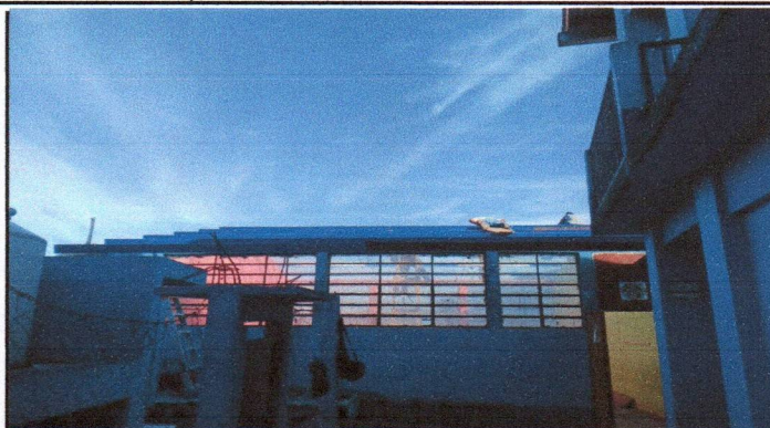
Foto2: Sustrucción de lámina, por lámina troquelada de aluzinc calibre 26
