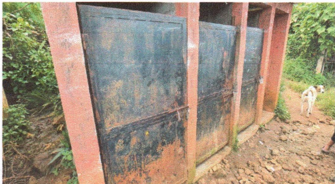
Foto 4: Sustrucción de puertas en servicios sanitarios de 1.50 m. de alto por 87.50 cm de ancho
