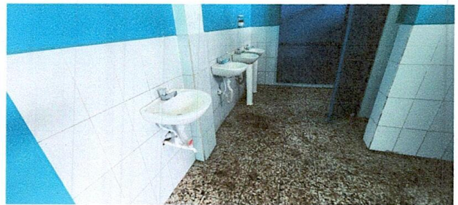
Foto 2: Lavamanos en funcionamiento para su uso.
