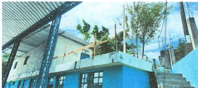
Foto 3: Falta de pintura para laboratorio de computación y sustitución de baranda metálica.
