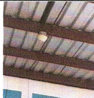
Foto 6: Poca iluminación y focos quebrados
