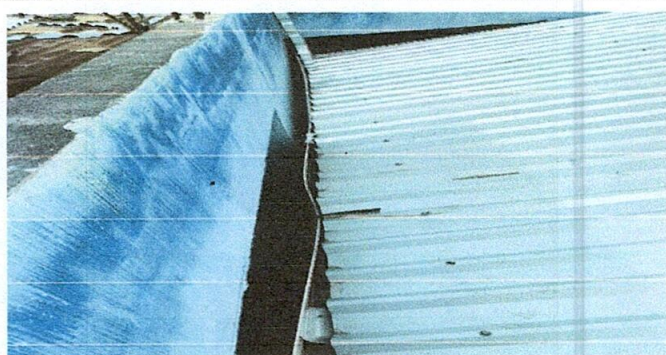
Foto 3: CANAL EN MAL ESTADO
