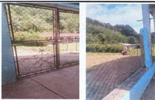
Foto 9: portón y mayas de circulación en malas condiciones
