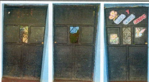
Foto 3: Mantenimiento de puertas de aulas en mal estado
