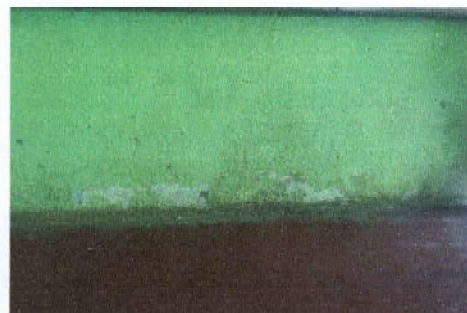
Foto 8: Paredes de aulas en malas condiciones rayadas y sucias
