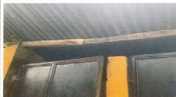
Foto 2: Techo de baños en mal estado
