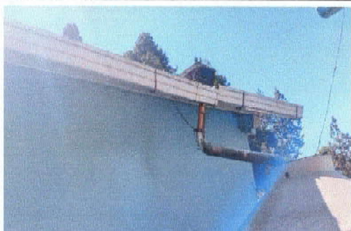
Foto 7: Canales en mal estado
