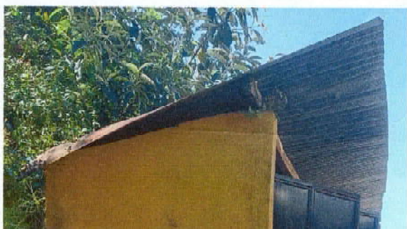
Foto 1: Laminas de baños en mal estado
