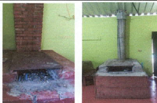
Foto 10: Planchas de cocina en mal estado
