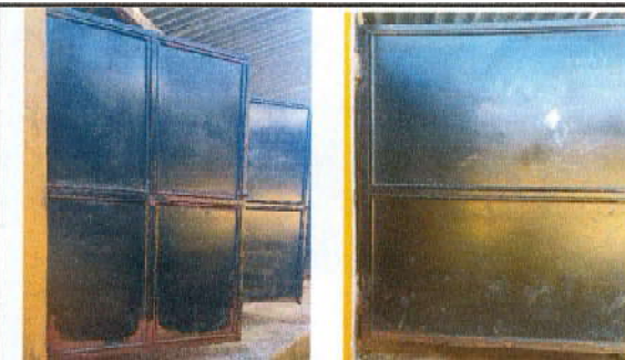
Foto 4: Puertas de baños en mal estado
