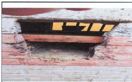
Foto 12: no hay chimenea
