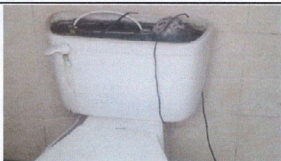
Foto 7: Baños en mal estado
