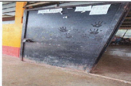
Foto 4: puertas ne mal estado
