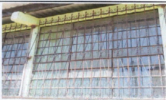
Foto 5: balcones en mal estado
