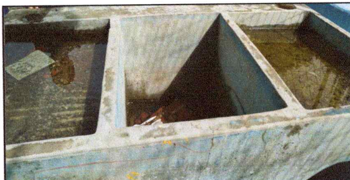
Foto 6: PILA EN MAL ESTADO
