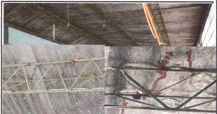
Foto 2: Daño en estructura de soporte de metal
