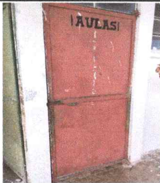
Foto 3: Daños en puertas
