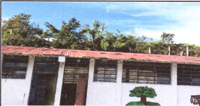
Foto1: Daño en techos de aulas
