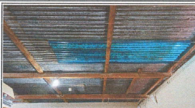
Foto 2: Deterioro de material por el paso del tiempo
