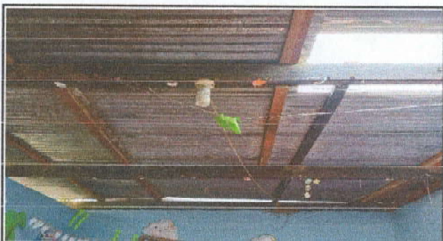
Foto 3: Deterioro de material y filtración de agua en temporada de lluvia
