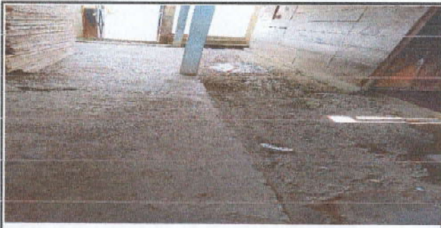
Foto 9: Piso exterior en mal estado
