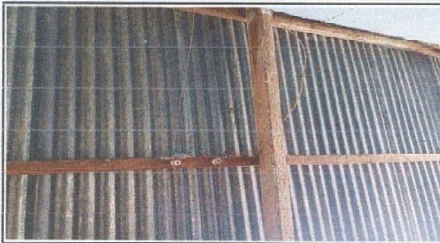
Foto 7: Deterioro del cable de energia electrica
