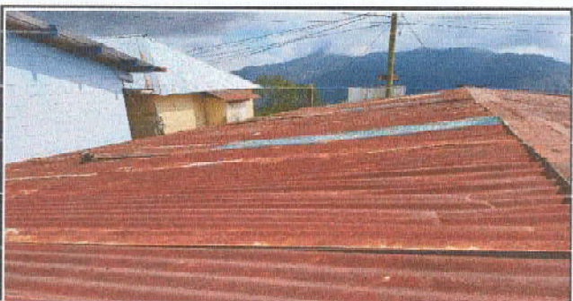
Foto 5: Deterioro y abertura del techo en el cual ingresa agua en temprada de lluvia
