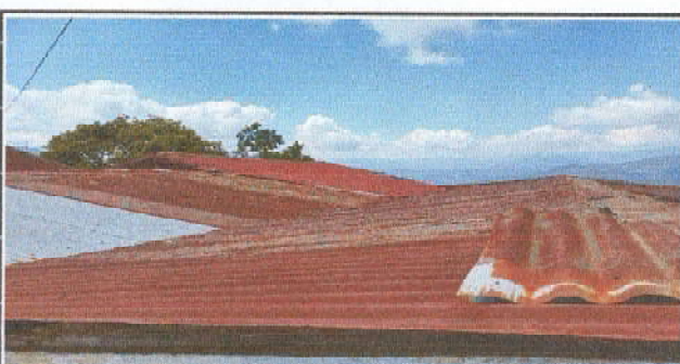
Foto 6: Material desgastado del techo con el paso del tiempo
