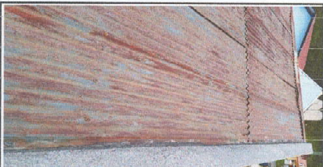
Foto 11: Filtracion de agua en temporada de lluvia
