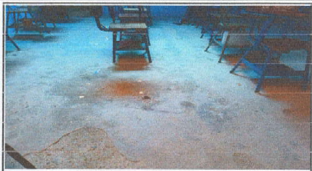
Foto 8: Piso interior de las aulas en mal estado
