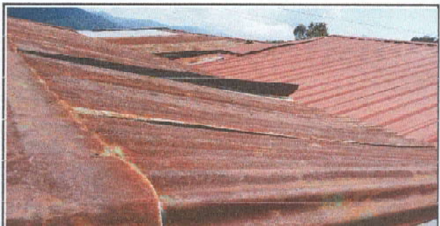
Foto 10: Deterioro del techo lo cual provoca la filtracion de agua
