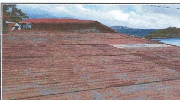
Foto 4: Deterioro del techo
