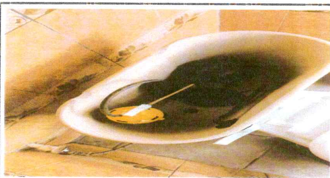
Foto 5: Accesorios y contra llave de sanitarios en mal funcionamiento.
