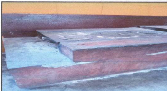
Foto 2: Estufa Artesanal agrietada y plancha en mal estado
