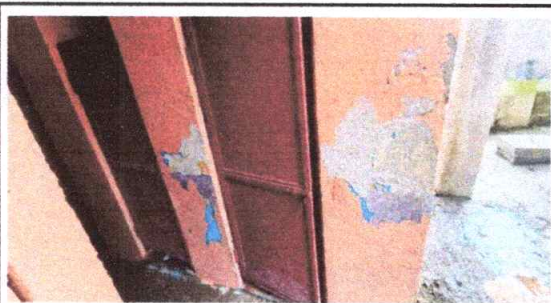
Foto 3: Sustrucción de pintura.
