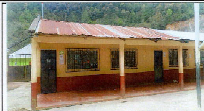
Foto 1: Lamina en mal estado donde la madera ya esta deteriorada.
