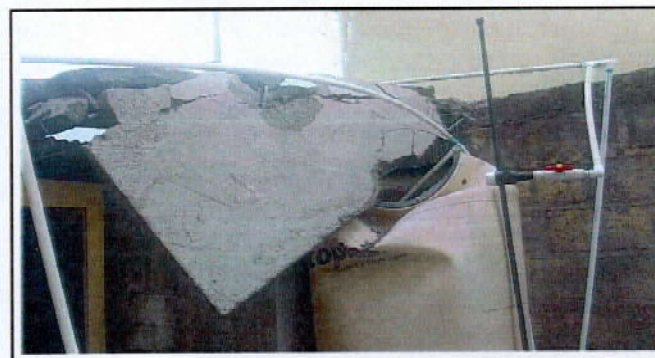
Foto 6: Daño en el deposito de agua del establecimiento y la base
