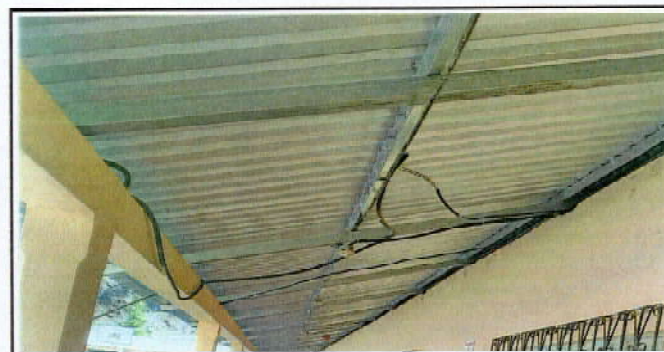
Foto 12: El sistema del cableado está en mal estado y provoca que las aulas no tengan el servicio de energía eléctrica, lo cual afecta la visibilidad dentro del aula por que no hay demasiada iluminación.
