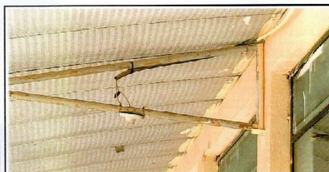
Foto 11: Cables de alta tensión expuestos y poniendo en riesgo a los estudiantes
