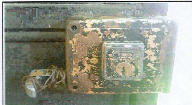
Foto 10: Chapas en mal estado que han ocasionado que las puertas queden remachadas y que se fuercen las puertas
