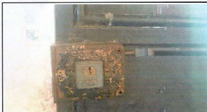
Foto 9: Las chapas de las puertas están en mal estado lo que ocasiona que personas ajenas ingresen al establecimiento
