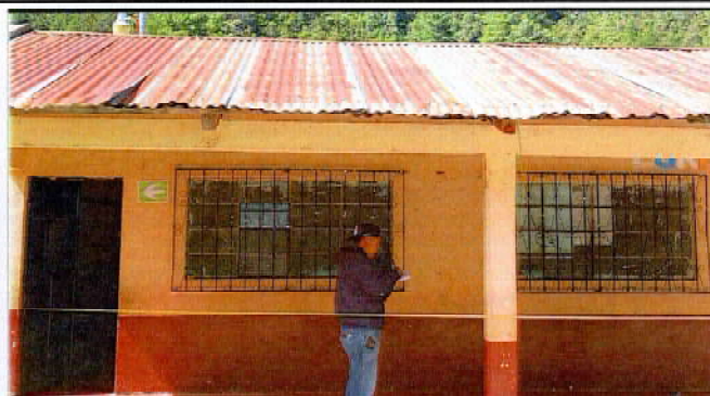
Foto 2: Abertura entre el techo que permite el ingreso de agua esta es la imagen frontal del aula donde el techo se encuentra en mal estado tiene una medida de 88 metros cuadrados.
