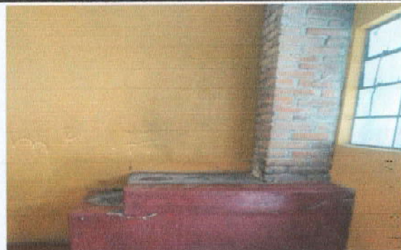
Foto 4: Chimenea en mal estado y la base de la plancha agrietada
