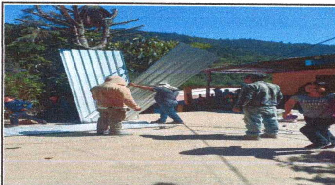
Foto 3: Cambio de láminas de techo en mal estado.
