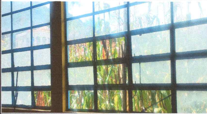
Foto1: Ventanas sin vidrios.
