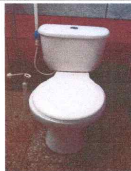
Foto 6: Inodoros en malas condiciones
