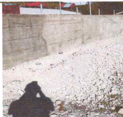
Foto 2: Muro perimetral en malas condiciones
