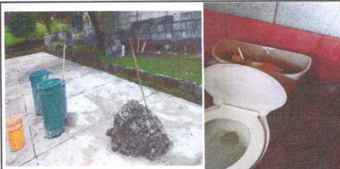
Foto 6: Inodoros en malas condiciones
