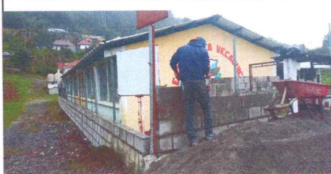
Foto 2: Muro perimetral en malas condiciones
