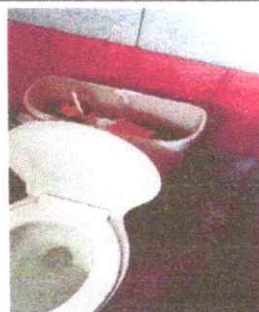
Foto 6: Inodoros en malas condiciones
