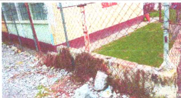
Foto 2: Muro perimetral en malas condiciones
