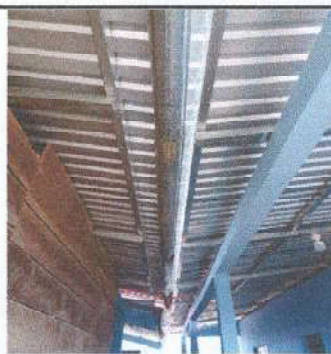
Foto 6: Material desgastado canal de agua pluvial
