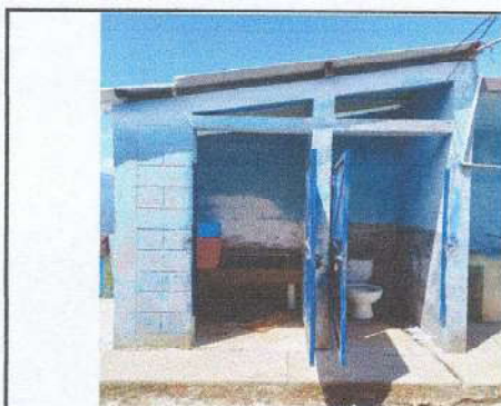
Foto 9: Sanitarios y mingitorio en mal estado
