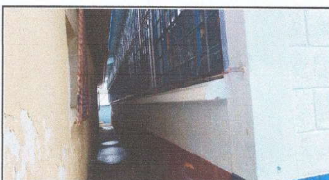
Foto 10: Deterioro del canal de agua lluvia lo cual provoca la filtracion de agua en las aulas en temporada de lluvia
