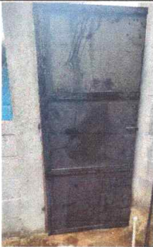
Foto 3: Sustrución de puerta (2.10m de alto * 1.00m de ancho)
