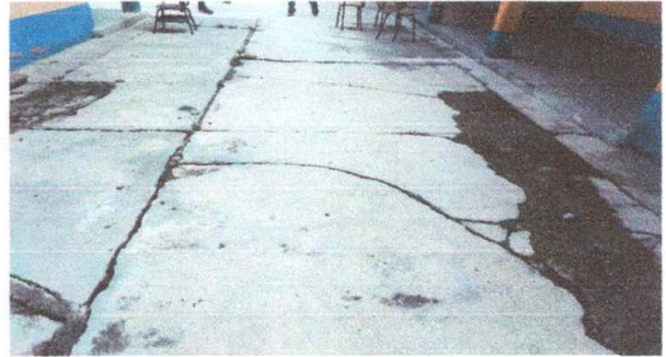
Foto 2: Piso inseguro para los estudiantes por deterioro
