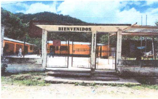
Foto 1: Imagen del porton en mal estado de las mayas y el marco
