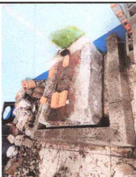
Foto 9: Sustitución y ampliación de estufa rural a estufa de 2 planchas (Completa)
