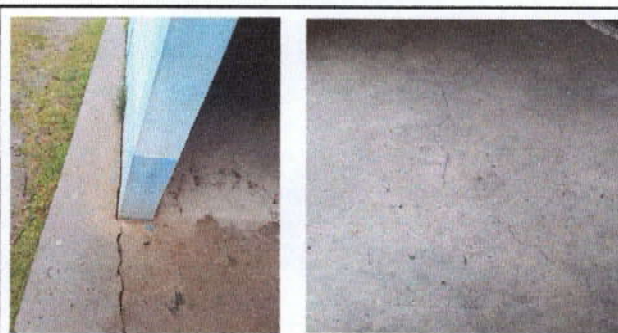
Foto 6: reparación del piso por mal estado debido a grietas.
