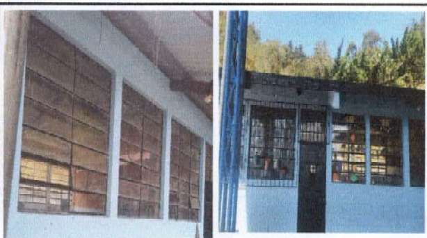
Foto 3: se necesita balcones en 6 aulas debido a la falta de campo recreativo por lo que los niños quiebran los vidrios con la pelota y para evitar robos.
