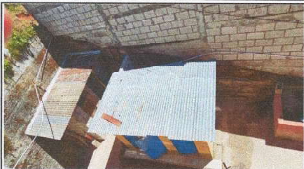
Foto 1: Techo de baños en mal estado
