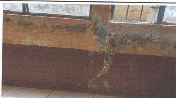
Foto 12: Pared en mal estado
