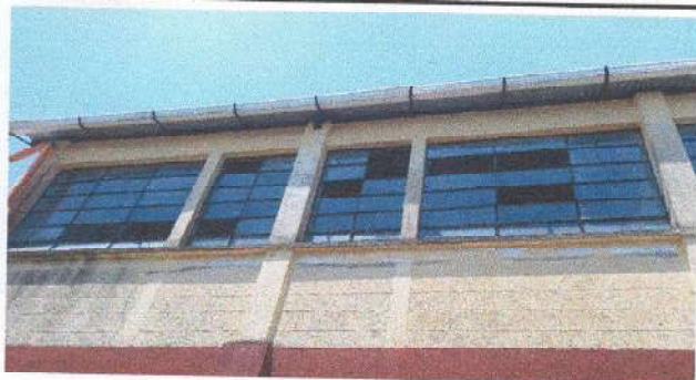
Foto 7: Ventanas sin vidrios
