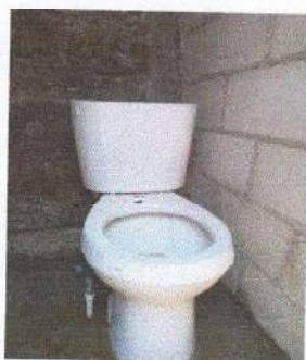
Foto 9: Inodoros en mal estado
