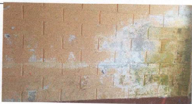
Foto 11: Pared con mucha humedad
