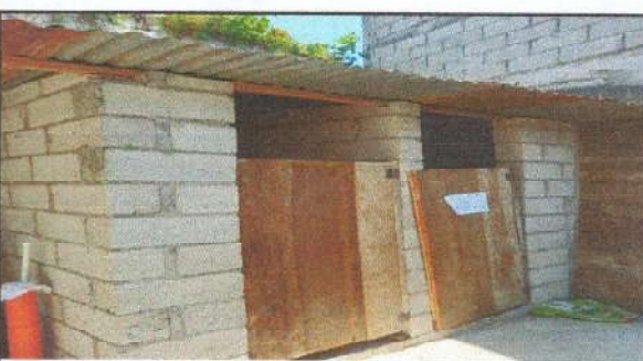
Foto 6: Puertas de baño en mal estado
