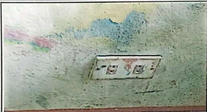
Foto 19: TOMA CORRIENTES DAÑADOS.
