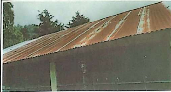
Foto 2: TECHO EN MAL ESTADO
