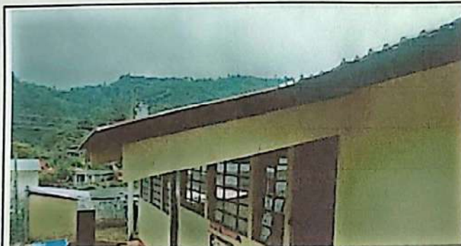
Foto 3: TECHO SIN CANALES DE AGUA
