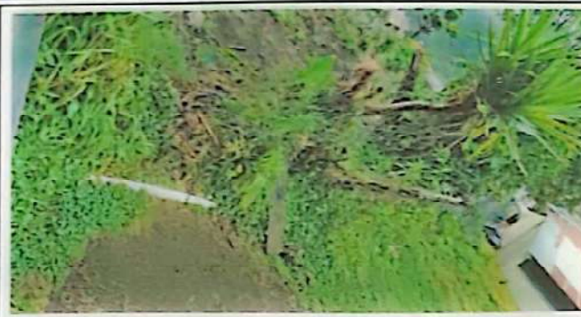
Foto 14: MALLA Y ALABRES EN MAL ESTADO.
