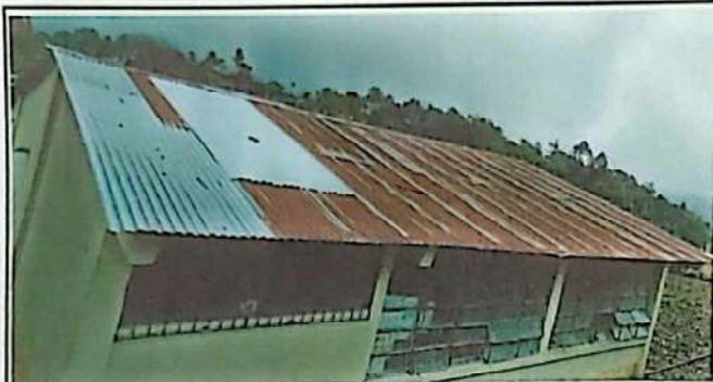
Foto 1: TECHO DETERIORADO CON EL PASAR DEL TIEMPO.
