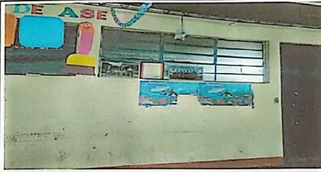
Foto 4: PAREDES EXTERNAS E INTERNAS MANCHADAS.
