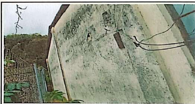
Foto 24: PARED DEL AULA CON GRIETAS Y FILTRACION DE AGUA.
