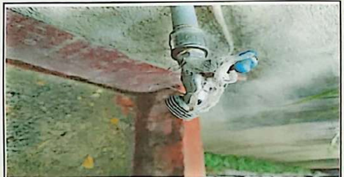
Foto 12: CHORROS EN MAL ESTADO.
