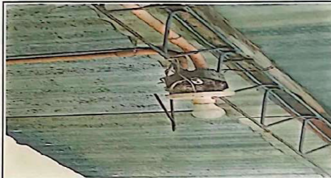
Foto 16: CAJAS Y PLAFONERAS DETERIORADAS.
