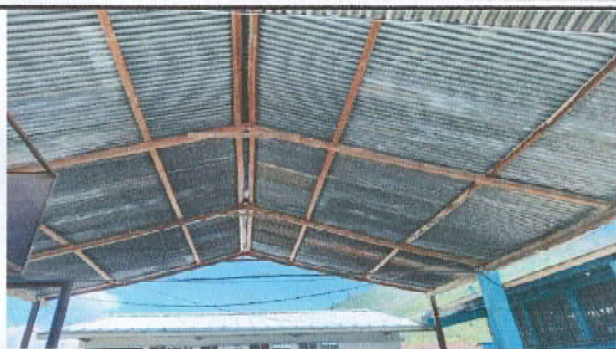
Foto 1: Imagen del techo agujerado y en mal estado
