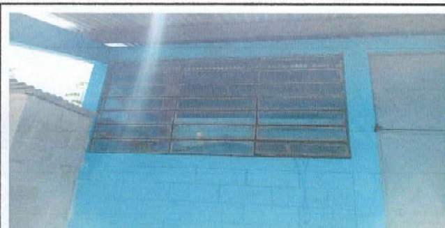
Foto 5: Falta de balcón
