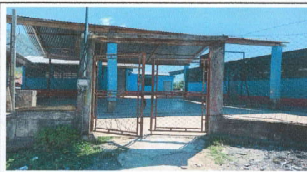
Foto 4: Portón en mal estado
