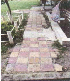
Foto 12: Plancha de concreto de patio en mal estado.
