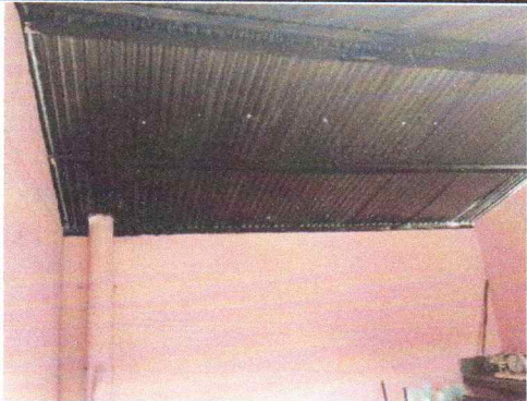
Foto1: Lamina de cocina en mal estado.
