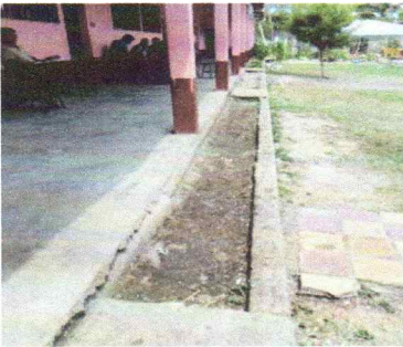
Foto 11: Banqueta de concreto en mal estado.
