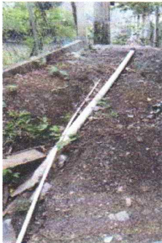
Foto 5: Línea principal de aguas negras en mal estado.
