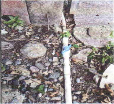
Foto 7: Caja de llave de paso en mal estado.
