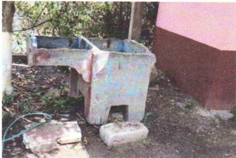
Foto 4: Pila de concreto en mal estado.
