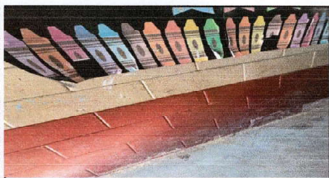
paredes en deterioro en pintura, las cuales se pintaran.
