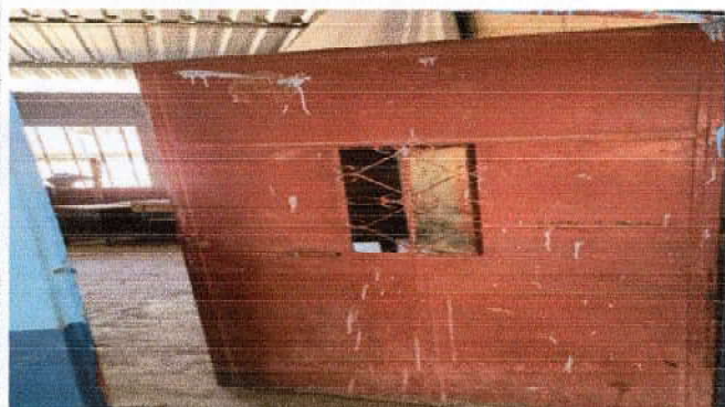
puertas en mal estado, serán restauradas con sus respectivas chapas
