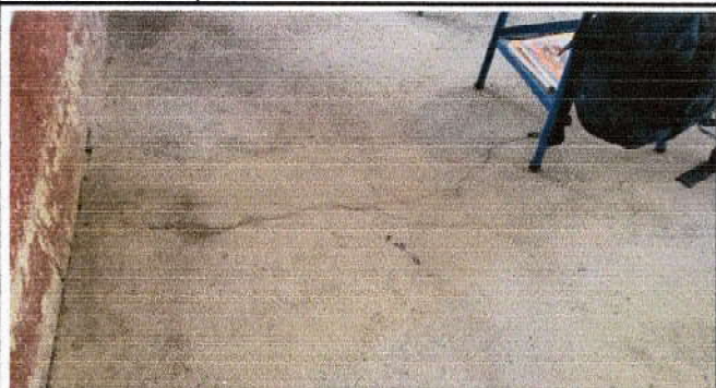
La torta de cemento se encuentra con grietas, las cuales serán restaurado módulo
