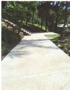
Foto No.9 TORTA DE CONCRETO REMOZADO
