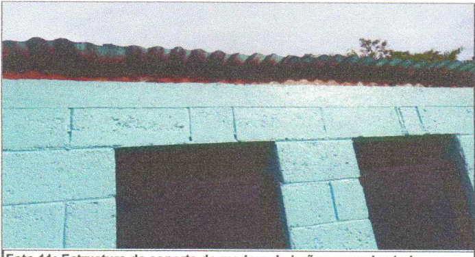
Foto 11: Estructura de soporte de madera de baños en mal estado.
