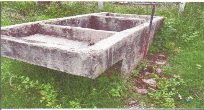
Foto 6: Pila de concreto en mal estado.
