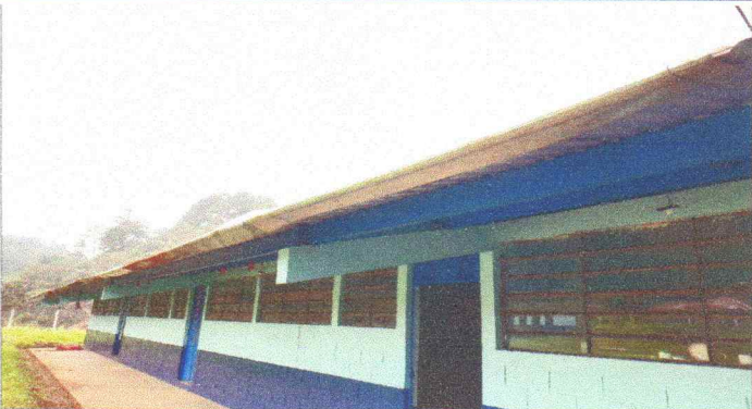
Foto 2: Canales en pésimas condiciones.
