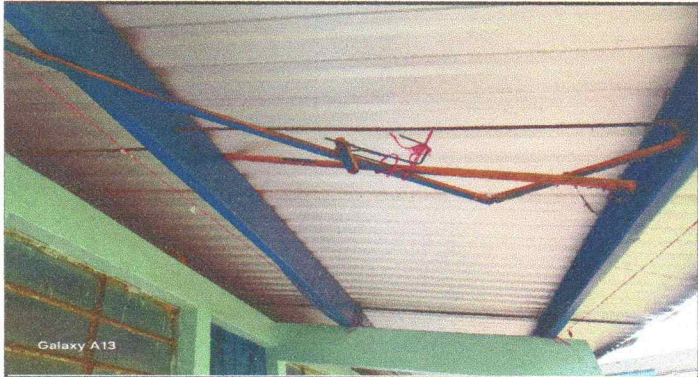
Foto 9: Ductos doblados y quebrados.
