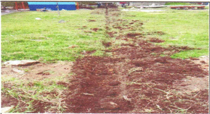
Foto 10: Red de drenaje en mal estado.
