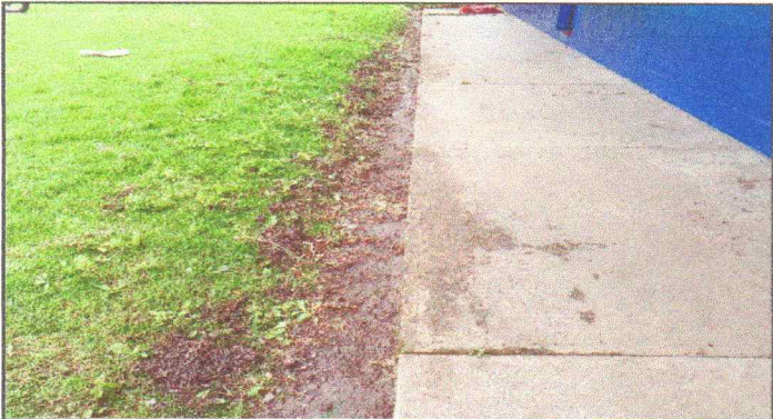
Foto 3: Cuneta en mal estado.
