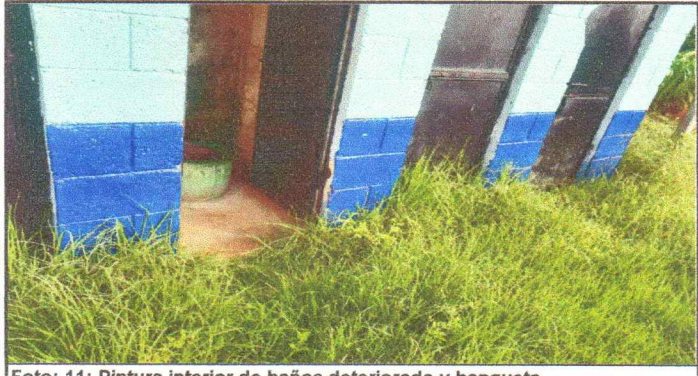
Foto 11: Pintura interior de baños deteriorada y banqueta.
