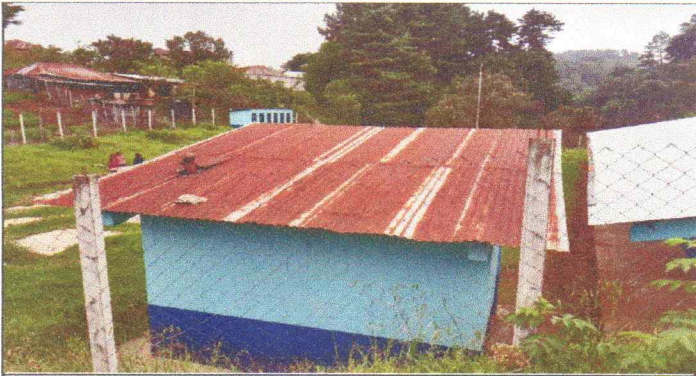
Foto1: Cubierta de lámina de cocina oxidada y agujereada.
