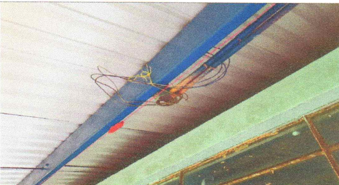
Foto 4: Cableado eléctrico en mal estado, falta de plafoneras y focos.
