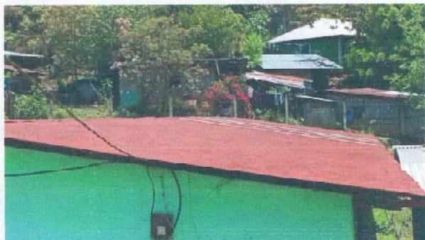
Foto 1: Sustrucción de lámina y capote por caída de agua en techo de una bodega y dos aulas
