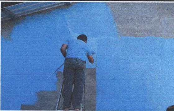
Foto 5: Pintura en muro perimetral
