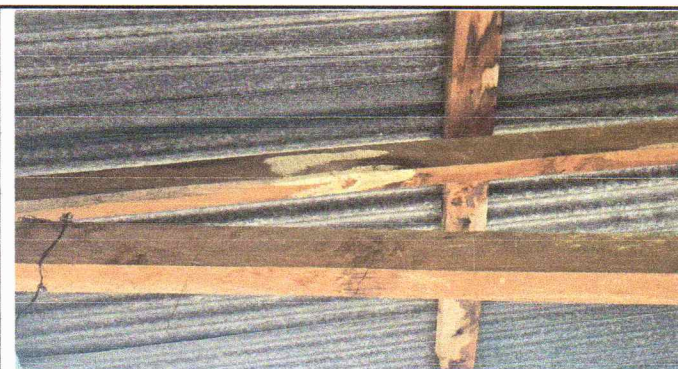
Foto 5: Estructura de techo de madera en proceso de descomposición.
