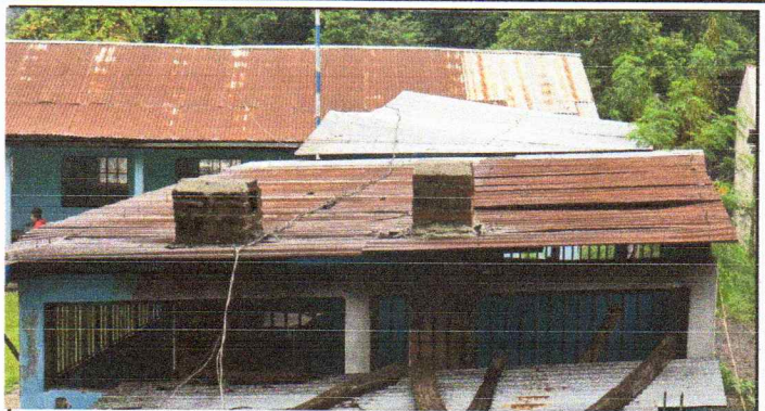
Foto 2: Situación actual del techo de la cocina y el escenario.
