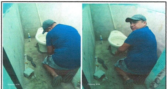
Foto 4: SERVICIOS SANITARIOS Y SUS ACCESORIOS
