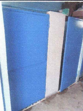
Foto : ANEXO 2: 2 Puertas en Sanitarios
