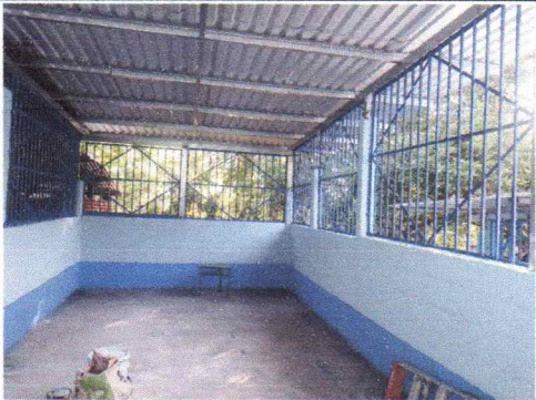
Foto : ANEXO 1: Evidencia en Techo, Balcones, Pintura en interiores y piso de torta de concreto
