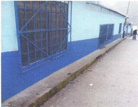
Foto 14: Repello en muro (como socalo por filtración)
