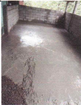
Foto 9: Sustrucción de piso de torta de concreto
