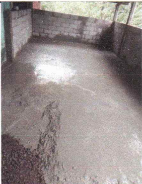
Foto 9: Sustrucción de piso de torta de concreto
