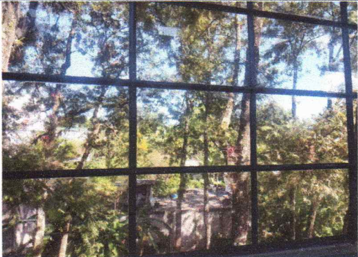
Foto7: Sustrucción de estructura de metal de ventana
