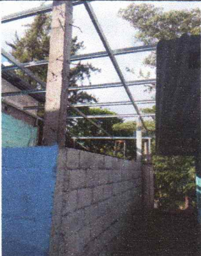
Foto 8: Sustrucción de malla por balcones de metal
