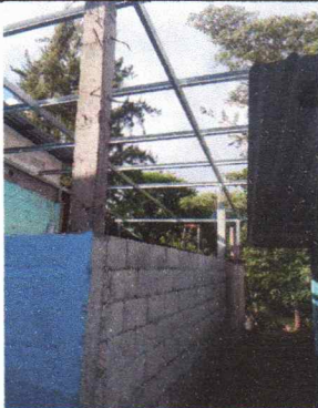
Foto 8: Sustrucción de malla por balcones de metal
